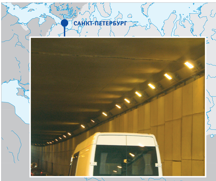
Санкт-Петербург. Освещение тоннеля
