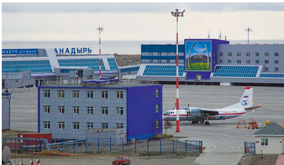
Высокомачтовые опоры освещения, аэропорт «Анадырь»
