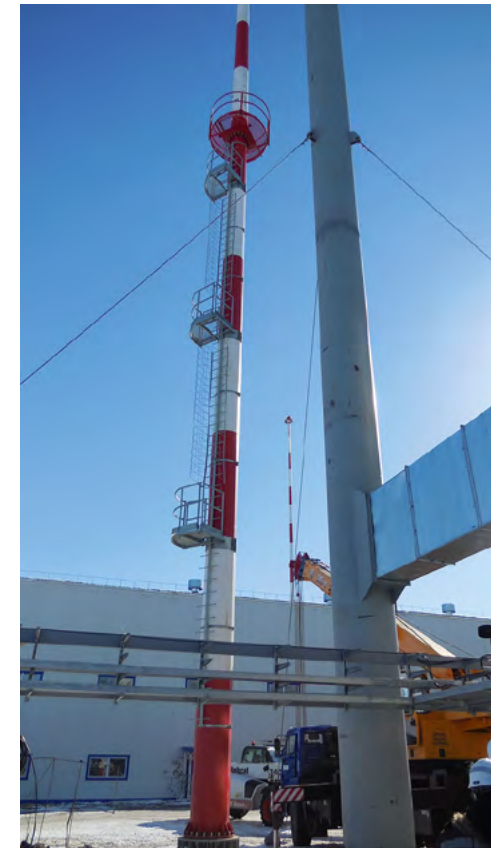
Молниеотводы и высокомащтабовые опоры, Термокарстовое месторождение
