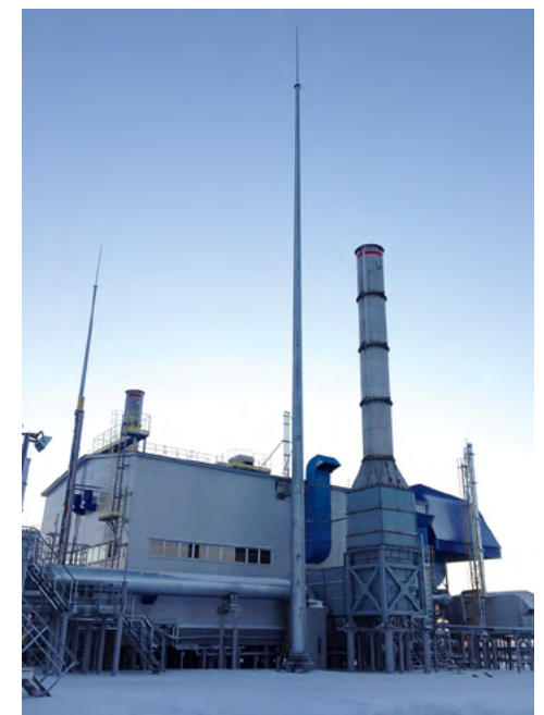
Молниеотводы и высокомащтабовые опоры, КС «Байдаракская»
