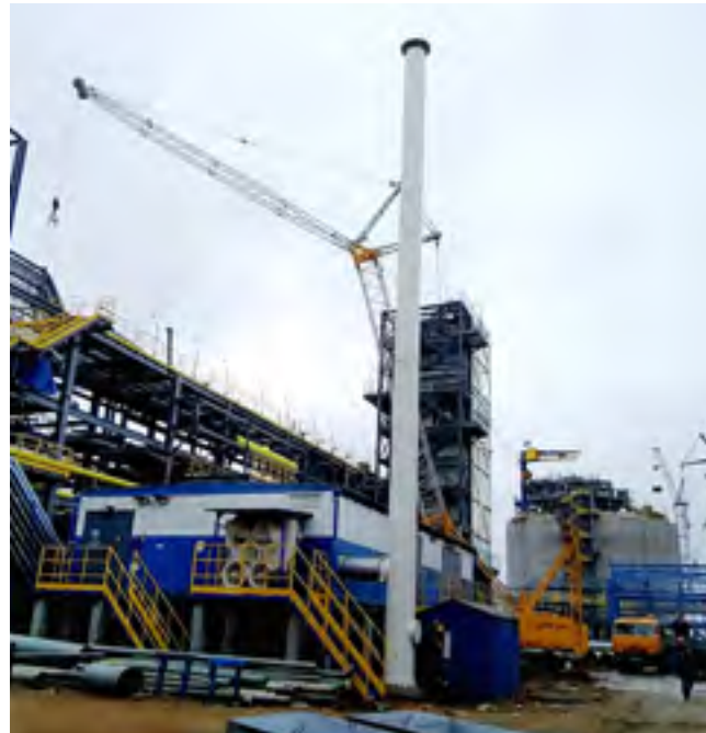
Воздухозаборная труба, СПГ Высоцк
