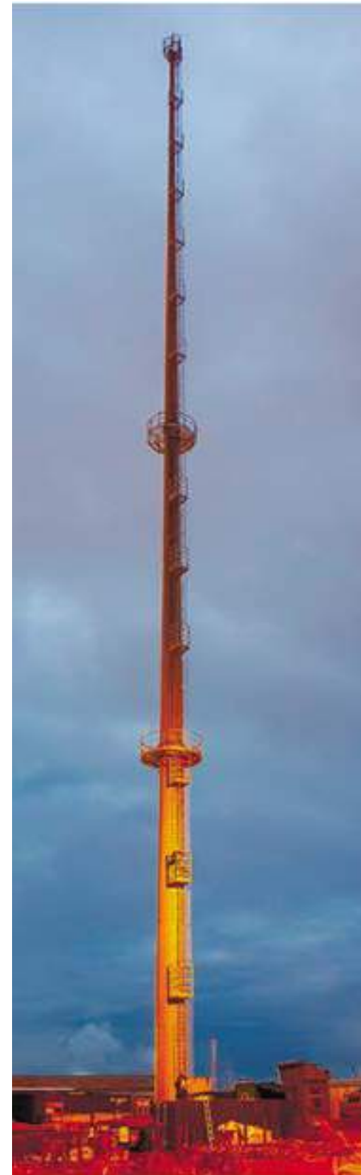
Молниезащитный комплекс 90 м Завод ПАО «Сибур», Тобольск
